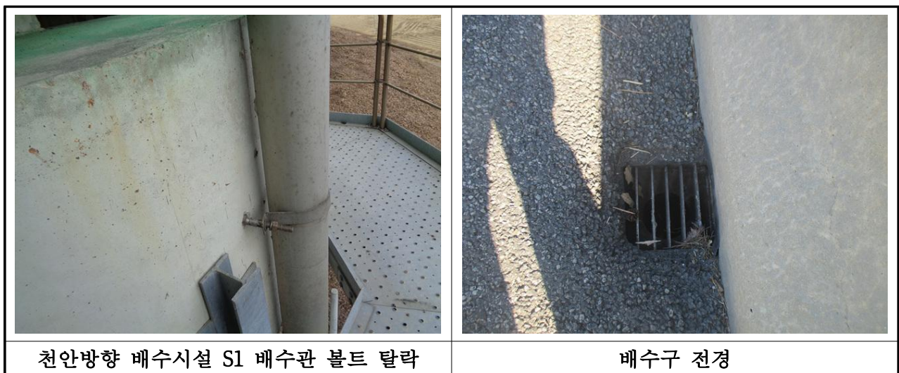
【사진 3.21】 배수관 손상현황
