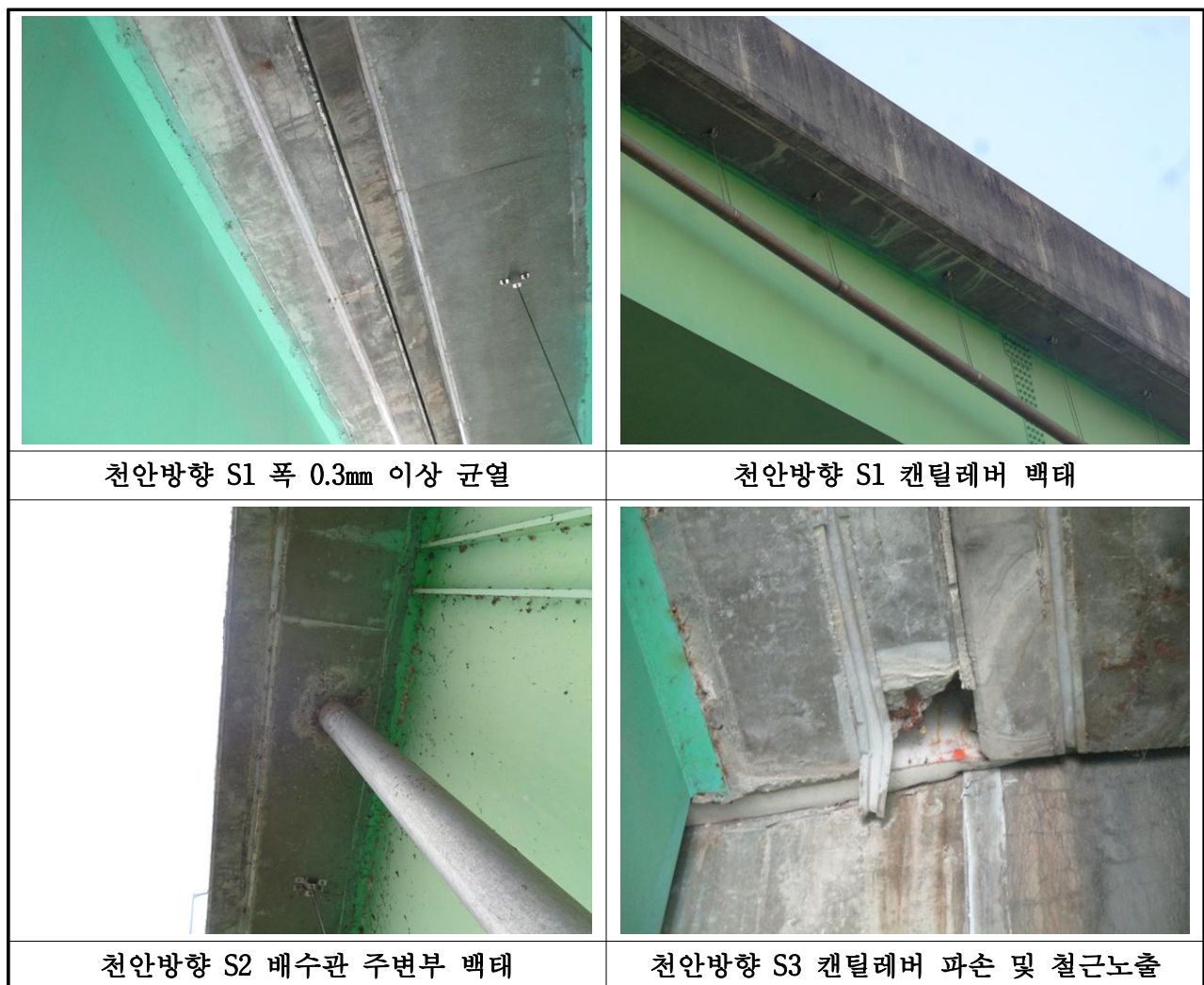
【사진 3.3】 바닥판 손상현황
