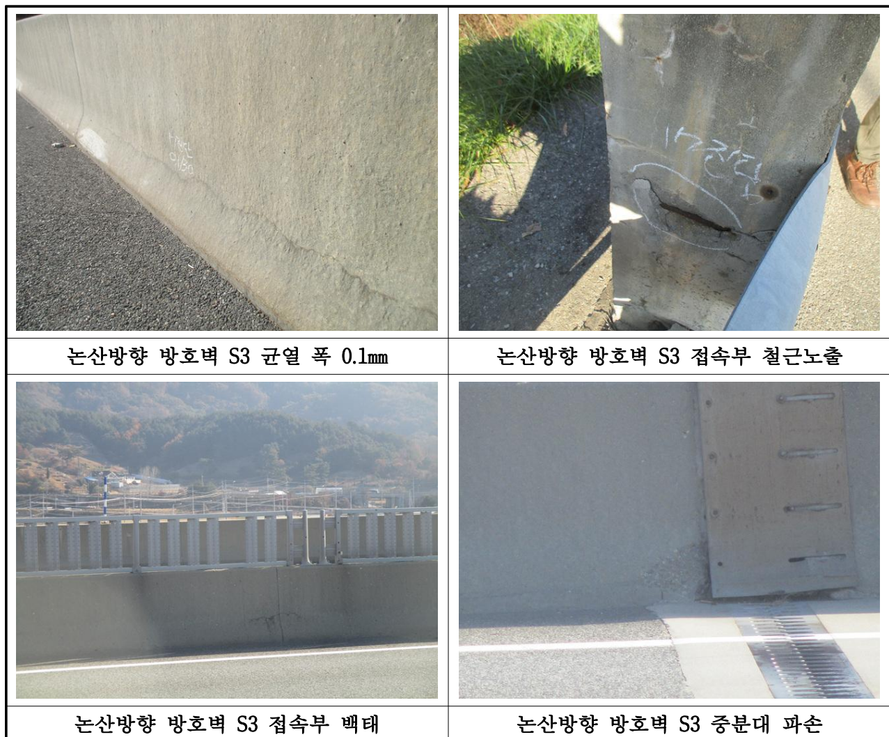
【사진 3.45】 난간 및 연석 손상현황
