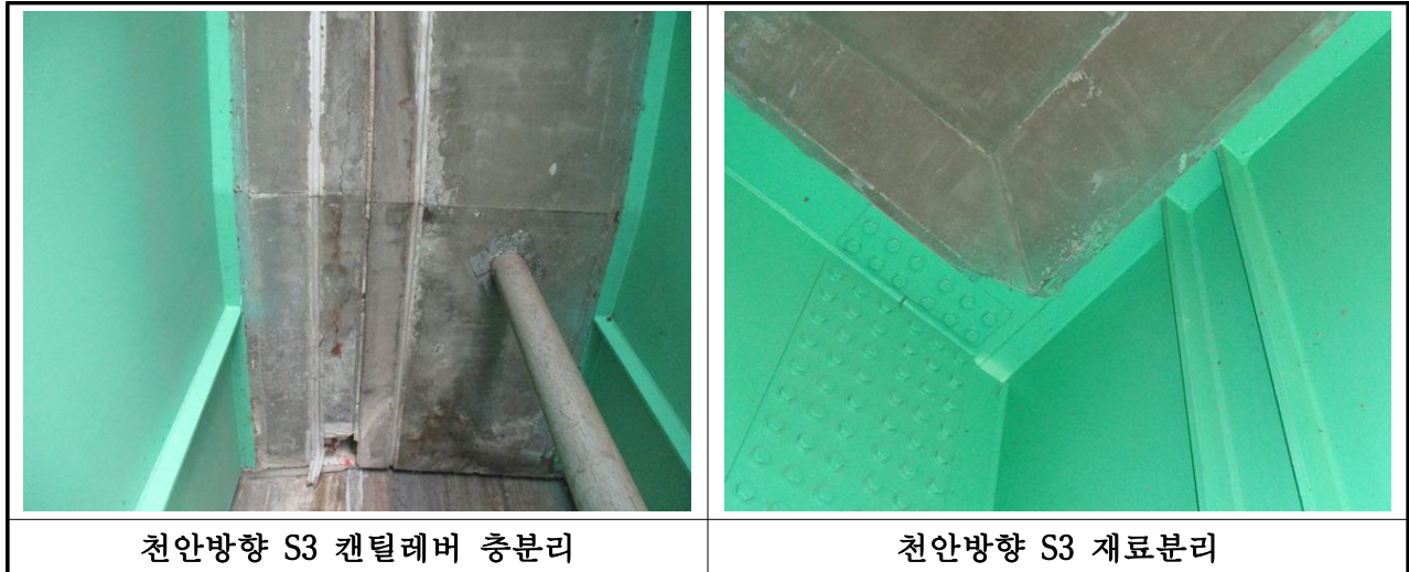
【사진 3.3】 바닥판 손상현황(계속)
